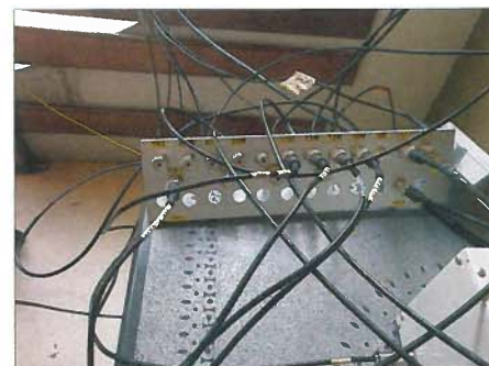
Dieses Schaltsystem erlaubte eine einwandfreie Zuordnung der Antennen.
